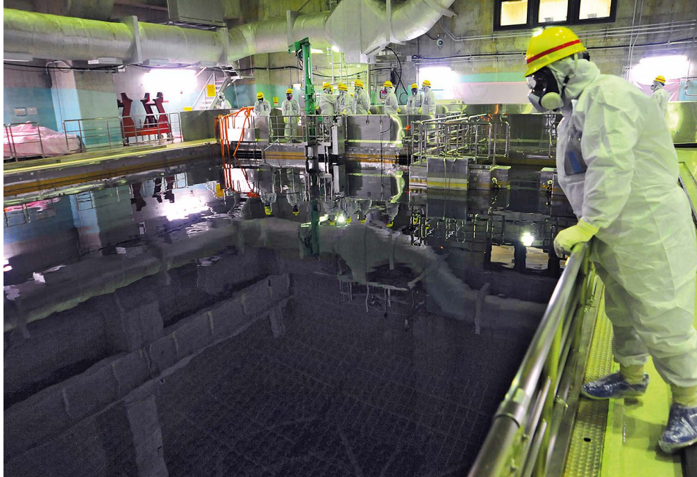
Billedet viser det midlertidige opbevaringsbassin til brugt atombrændsel på atomkraftværket Fukushima Daiichi i 2013. Hertil overførte man brændsel fra reaktor 4, som blev beskadiget ved en hydrogeneksplosion fire dage efter tsunamien i 2011. Foto: Greg Webb / IAEA CC BY-SA 2.0
