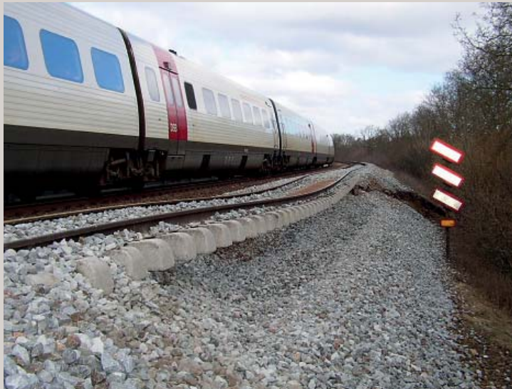
For cirka 10 år siden skred en cirka 100 år gammel banedæmning syd for Vejle udlagt over plastisk ler pludselig sammen. Foto: Torben Thorsen
