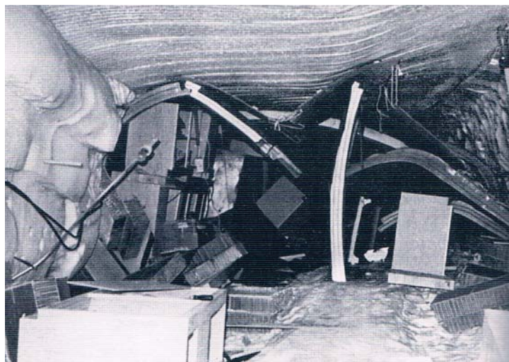
I sommeren 1969, tre år efter den definitive lukning af Camp Century, tog en fotograf udsendt af den amerikanske hær dette billede, der viser en sammenpresset mand-skabstunnel i den få år tidligere så omtalte by i indlandsisen. Foto: Austin Kovacs.
