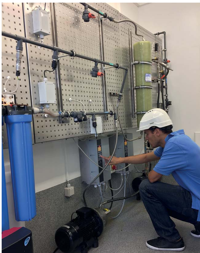
Mobilt pilotanlæg til geotermiske kilder med membran, pumpe og turbine. Anlægget er p.t. opstillet og er i drift ved Sønderborg. Det hele er placeret i en almindelig container.
