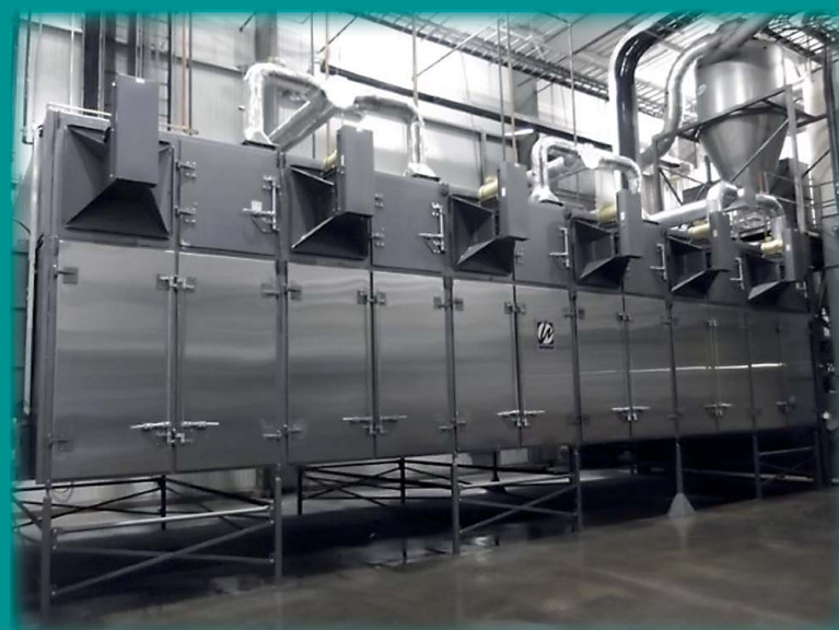
Industrielle varmluft-tørrere er ofte mere end 12 meter lange og 5 meter høje. Tørreprocessen står for mere end 60 % af det termiske energiforbrug ved produktion af fiskefoder.
